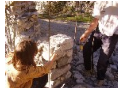
Vérification de l'aplomb de la tête de mur dans les deux directions.
