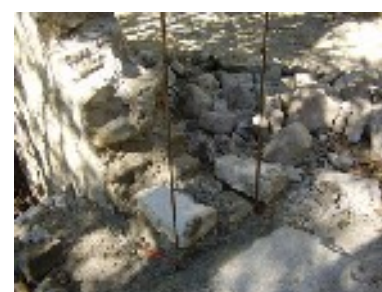
Mise en place de mortier et pose d'un premier lit de pierre.
