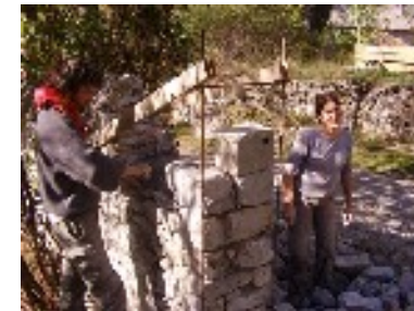
Attention à conserver l'homogénéité esthétique du mur !
