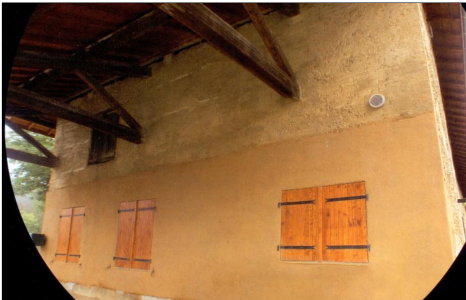
État de la grange Porcher avant et après l'intervention du laboratoire CRATerre. Photos de la double page extraites de : Pisé H2O, De l'eau et des grains pour un renouveau du pisé en Rhône-Alpes, Op. Cit.
