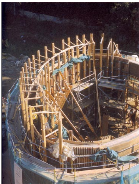
Coffrage réalisés pour bâtir la chapelle de la réconciliation, à Berlin, un bâtiment de forme ovoïde en pisé.
