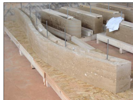
Etape de préfabrication des pièces en pisé à assembler au mortier de terre sur place.
