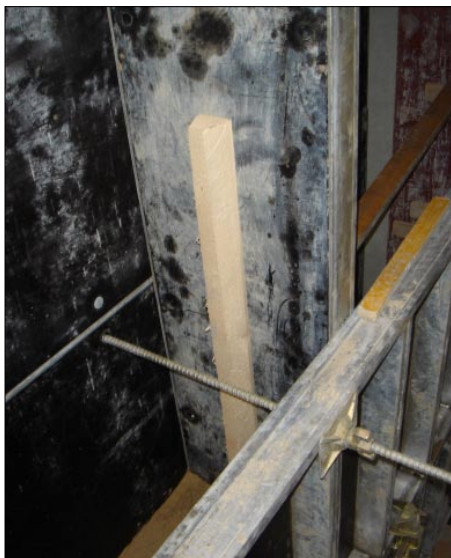
Pièce de bois pour réaliser les saignées de passage des câbles électriques.
