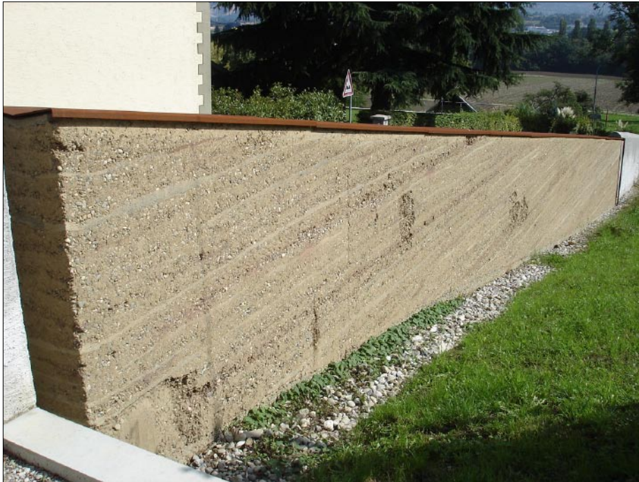
Mur d'enceinte de la mairie de Confignon réalisé en 2007. L'effet des strates rompant avec la pente du terrain est particulièrement mis en valeur par l'utilisation de terre rouge et de couches de chaux à certains endroits.
