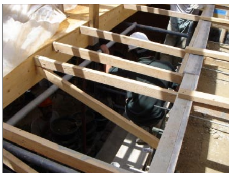
Contreventement du coffrage au niveau de la trémie. Le coffrage de bois sur mesure n'étant pas repris par les pinces et les clés de coffrage, il faut installer une multitude de pièces de bois pour retenir la pression exercée.
