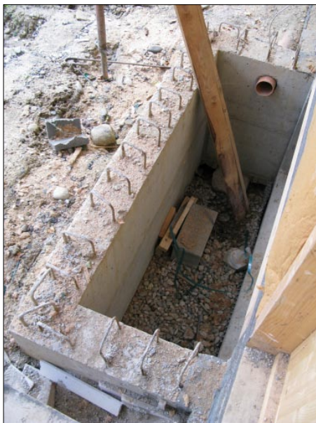
Le saut de loup côté patio permettant d'amener de l'air frais et de la lumière naturelle à la cave.
