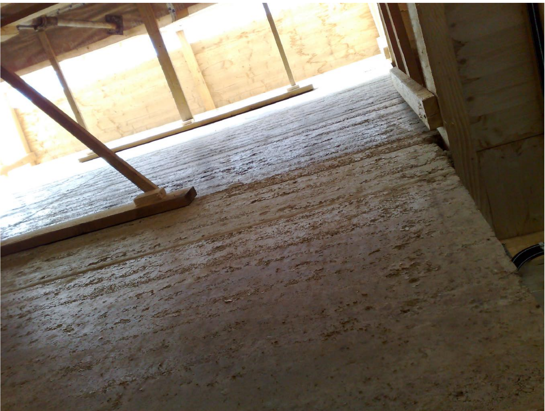
Vue depuis le rez-de-chausée. Le contre-jour est dû à l'ouverture des lanternaux non-réalisés. Des renforts provisoires contreventent le mur en attendant la mise en charge des solivages d'étage et de toiture.
