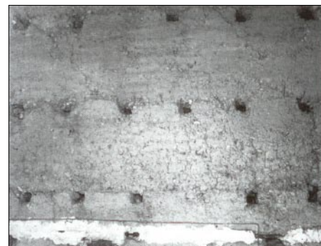
Mur intérieur de la grange d'une maison paysanne avec les trous de réservation pour les clés de banche. Photo extraite de : Les maisons rurales du canton de Genève, Op. Cit.
